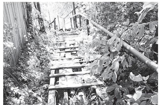
Пешеходный мост на Вельгии в аварийном состоянии
